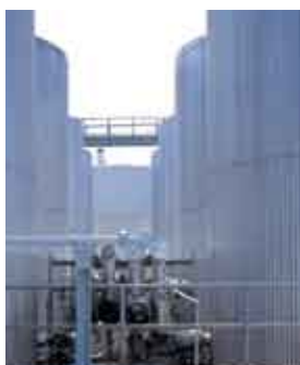
Réservoirs de stockage sur le site belge
