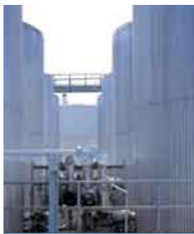
Opslagtanks op de Belgische site
